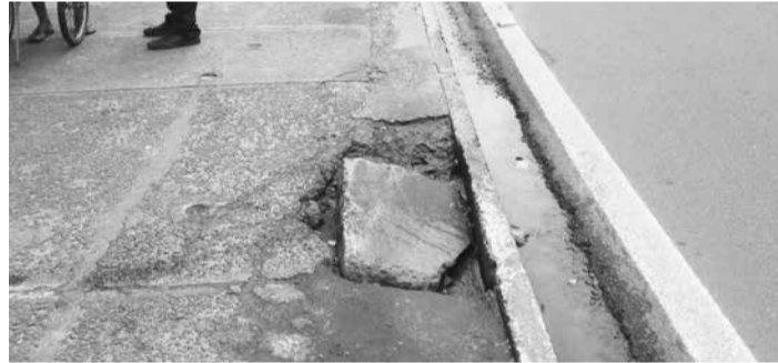
DESCASO Tampa quebrada dentro de buraco na avenida
